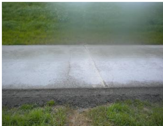
Рисунок 27 - Пример, образования трещины вблизи шва сжатия, который был нарезан
