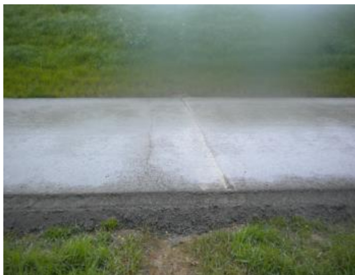
Figura 27 - Exemplu de formare a fisurii în preajma unui rost de contracție tăiat prea târziu
